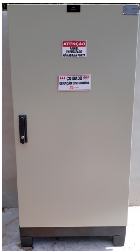
Figura 22: Painel de Proteção e Seccionamento
